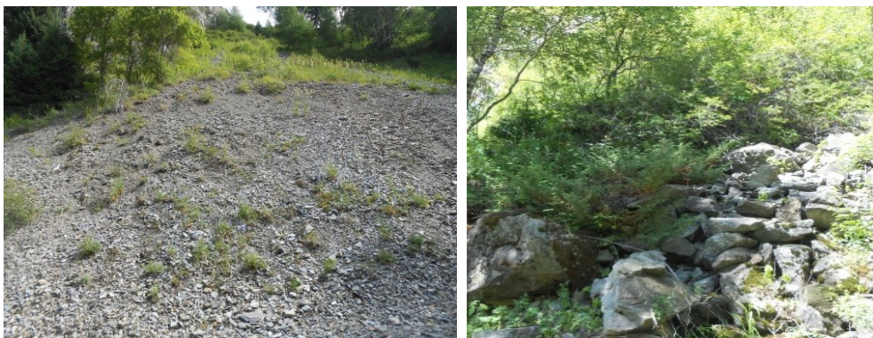
Рисунок 2 а - Осыпи, местами – оползни, многочисленные эрозионные промоины, выходы скальных пород
