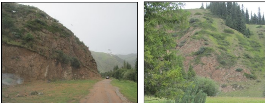
Рисунок 2 – Эрозионные процессы. Оползни, обвалы
